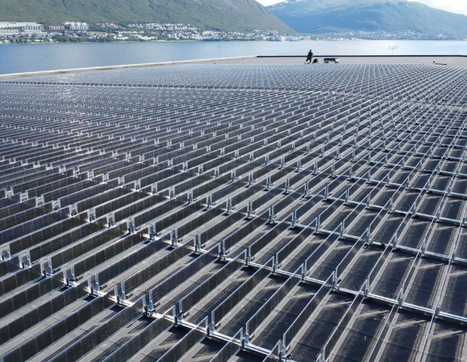
Vertikalt montert solcelleanlegg i Tromsø – Bilde: Over Easy Solar
